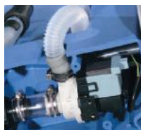
voorzien van afvoerpomp
